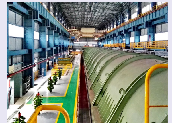
“一种烟气循环式预还原烧结工艺”专利应用示范——宝钢本部 2 号 600 平方米烧结机项目
