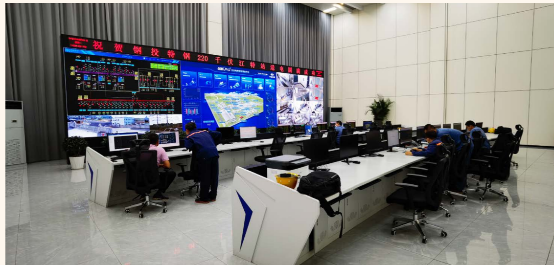
企业电网监控系统
