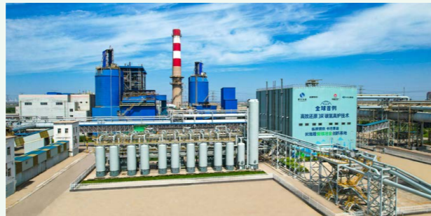
3R 碳氢高炉 EPC 项目
