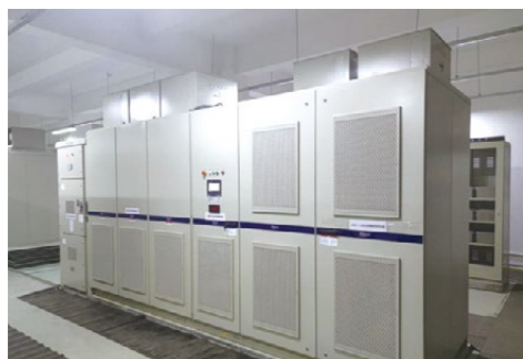
转炉二次除尘系统节能改造
